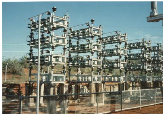
Banco de capacitores
